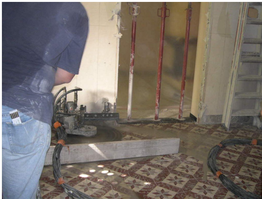
la machine est fixée sur le mur en béton
